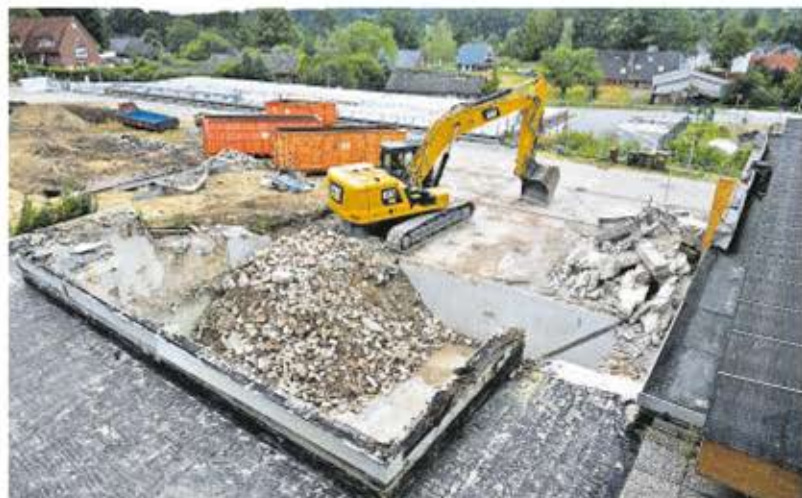
Ein Teil der Baugrube für den Neubau des Bettenhauses Pflege wird derzeit auf dem verwinkelten Gelände eingerichtet.
